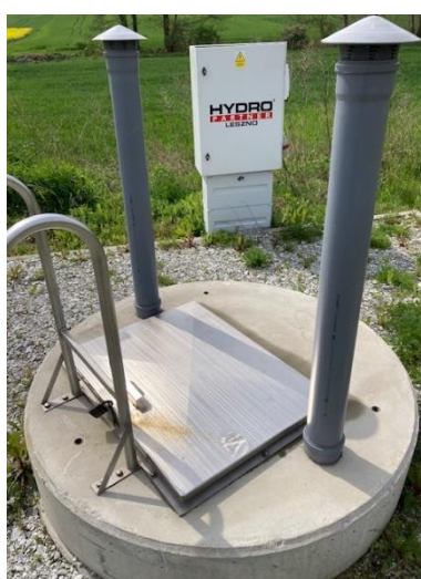
Pompownia ścieków na ul. E. Szczanieckiej w Księżu Wlkp.
